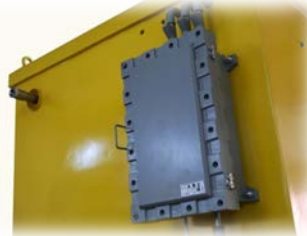
ЭЛЕКТРИЧЕСКАЯ ПАНЕЛЬ (EXPROOF- взрывозащищенный) Ex d IIB T6 IP55
